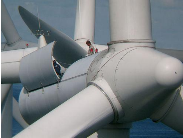
Mynd 2: Vélvirki við eftirlit í vélarhúsi vindrafstöðvar í nærri 100 m hæð.
