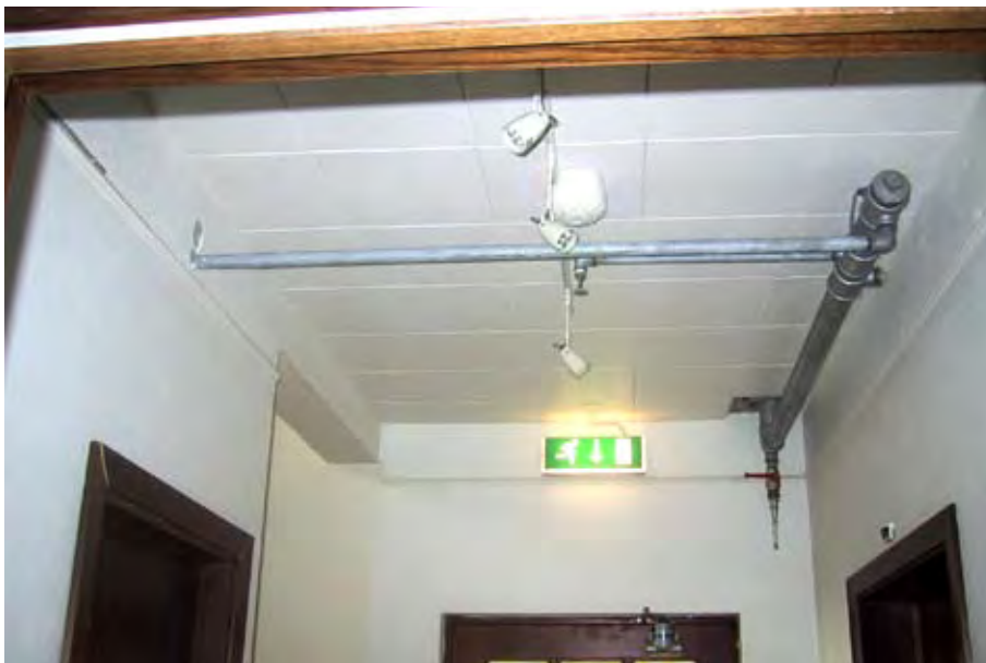
48. Áberandi sprinklerkerfi í hótélálmum Valhallar
